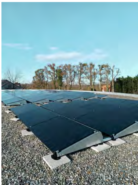
Panneaux solaires sur le toit du réservoir de Buross
