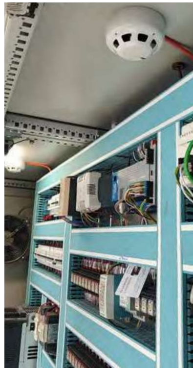
Armoire électrique de Pontacq
