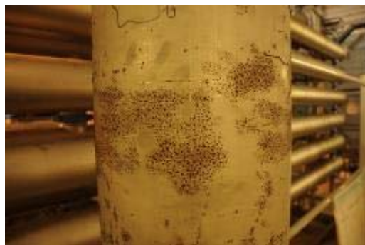
Photo 27 - Corrosion des canalisations inox de l'usine de Lespelle
