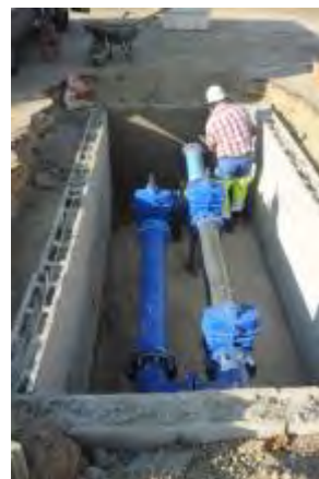
Photo 26 - Regard d'interconnexion SIEBAG
