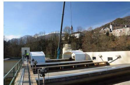
Photo 23 - Couverture des filtres à sable de l'usine d'Arthez-d'Asson
