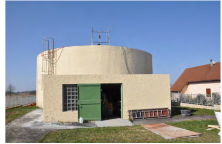
Photo 22 - Réservoir de Pontacq
